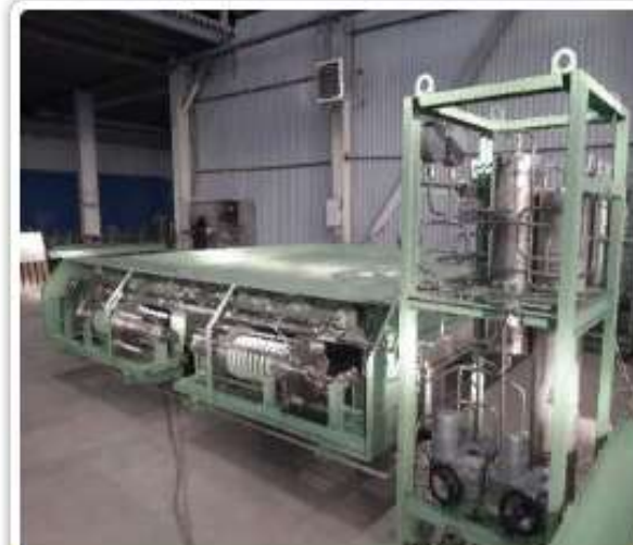
ОБОРУДОВАНИЕ СИСТЕМЫ ПАССИВНОГО ОТВОДА ТЕПЛА
